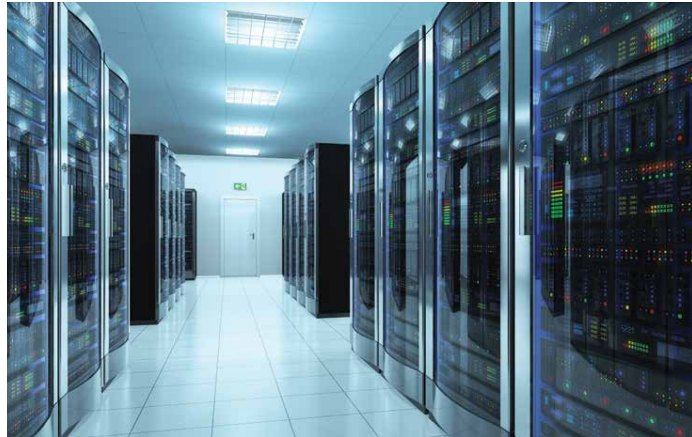
Sala de Servidores, Vodafone España
